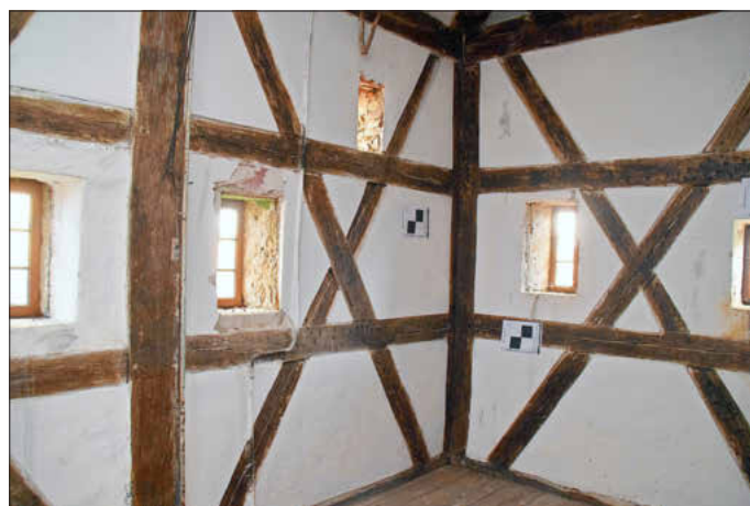
In den Innenräumen des Würzburger Torturms hat eindringendes Wasser Schäden angerichtet.
