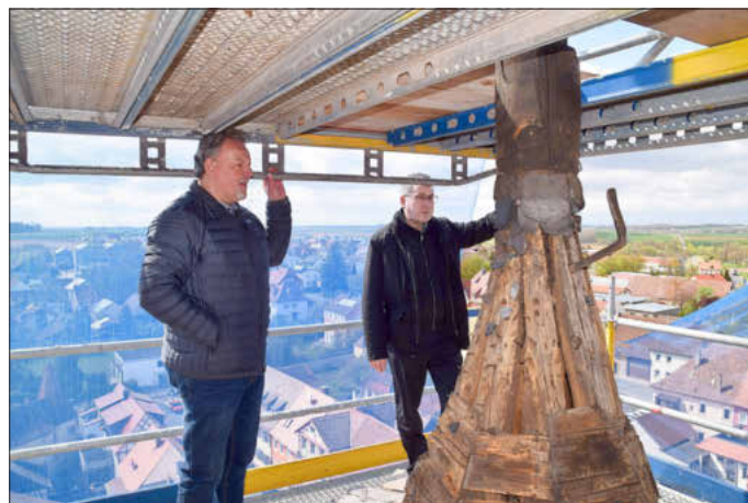
Bürgermeister-Stellvertreter Hermann Schuch (links) und Bürgermeister Wolfgang Lampe schauen sich die Schäden am Holz an.
