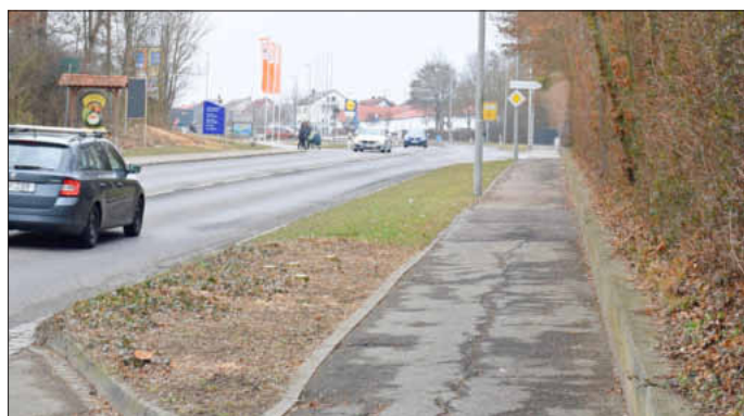
Die Bundesstraße 13 wird zwischen Kreisverkehr und Friedhofsweg saniert. Auch eine Ampel wird installiert.
