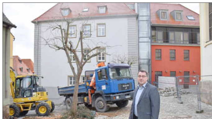
Der Platz zwischen Gasthaus, Rathaus und Stadtkirche wird umgestaltet. Das ist ein Projekt, das Bürgermeister Wolfgang Lampe in der Bürgerversammlung vorstellte. Das Bild entstand zu Beginn der Bauarbeiten.
