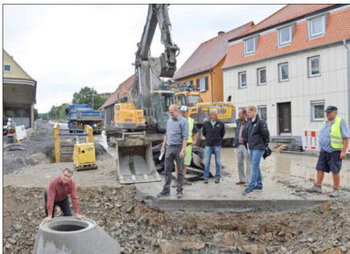
Vor Ort schauen sich Bürgermeister Wolfgang Lampe (links), Mitarbeiter der Verwaltung, des Planungsbüros und der Baufirma um.
