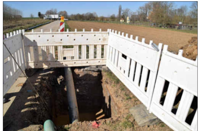
Kanal Brackenlohr Druckleitung
