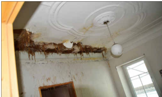
Das Löschwasser hat Spuren in den Decken hinterlassen.
